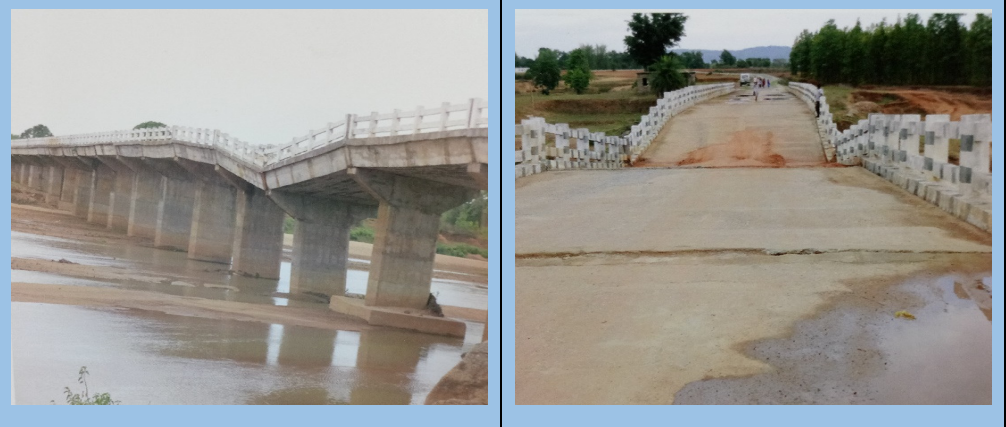
चित्र 2.10: रायडीह प्रखंड में मरियम टोली-सरनाटोली के बीच शंख नदी पर क्षतिग्रस्त पुल की तस्वीर
